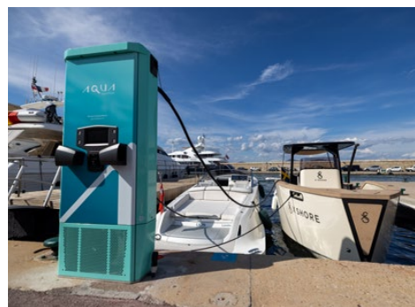
Borne de recharge électrique Aqua, quai d'accueil
